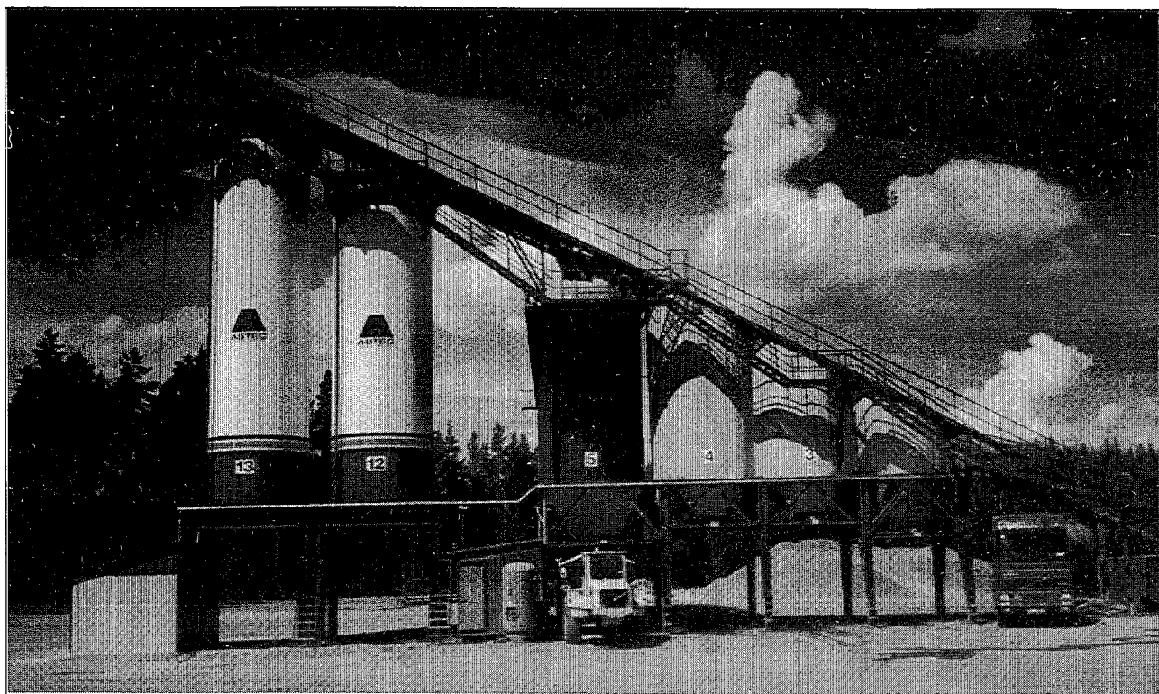
De två nya varmlagringsfickorna (längst till vänster) vid asfaltverket i Gustafs levererades av amerikanska ASTEC Industries Inc. Leverantören rekommenderar en maximal lagringstid på cirka fyra dygn.
